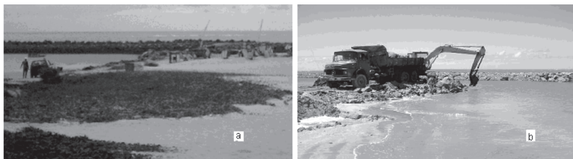
Figura 1 – Fotos da Praia de Candeias, Jaboatão dos Guararapes – Pernambuco: (a) espigão coberto pela areia da praia e quebra-mar ao fundo (ago/2004) e (b) retirada do espigão perpendicular à praia, permitindo a circulação da água na área interna do quebra-mar.
