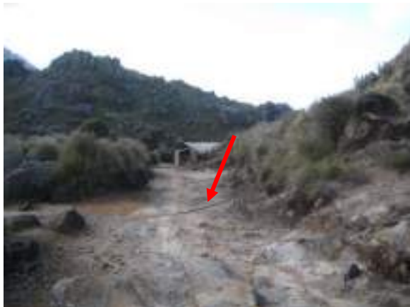
Figura 49: Cano exposto no caminho para o Abrigo Rebouças. Foto: Yukie Kabashima
