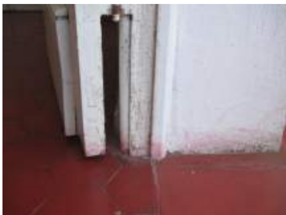
Figura 21: Manchas vermelhas do produto de limpeza na porta e parede do Centro de Visitantes. Foto: Yukie Kabashima
