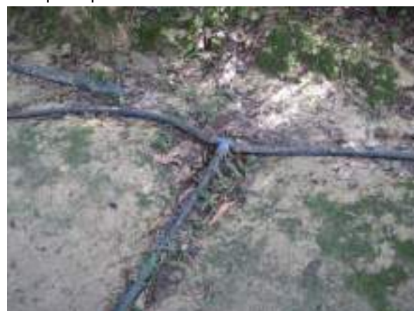
Figura 30: Detalhe dos canos expostos no caminho entre a estrada e os sanitários na área dos quiosques. Foto: Yukie Kabashima
