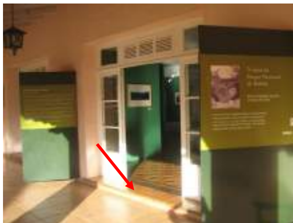
Figura 18: Degrau na saída das salas de exposições no segundo piso do Centro de Visitantes. Foto: Yukie Kabashima
