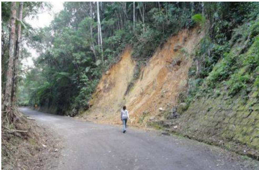
Figura 5.2 - Ponto 1 - Deslizamento rotacional em corte de estrada da BR 485 no extremo sul do PNI (Coordenadas UTM N0539991, E7518024), (Fotografia: Douglas Mendes).
