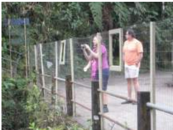
Figura 107: Tela de proteção na ponte do Maromba. Foto: Yukie Kabashima
