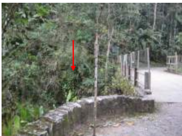
Figura 109: Lateral da Ponte do Maromba sem continuidade da tela de proteção. Foto: Yukie Kabashima
