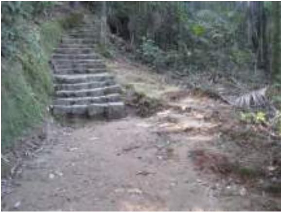
Figura 84: Base da escada com degrau muito alto, desvio na lateral e ausência de corrimão neste trecho. Foto: Yukie Kabashima
