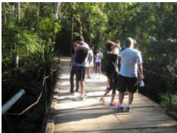
Figura 90: Ponte do Lago Azul com guarda corpo deteriorado. Foto: Yukie Kabashima
