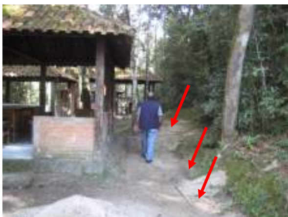
Figura 29: Canos expostos no caminho entre a estrada e os sanitários na área dos quiosques. Foto: Yukie Kabashima
